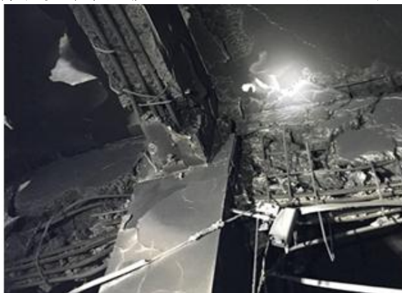
图 8 受到严重破损的梁柱
