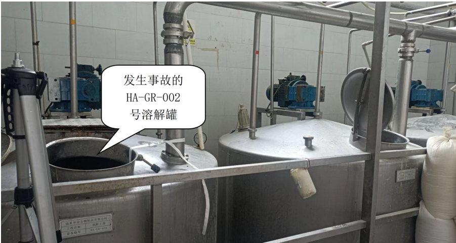
图 3 发生事故的溶解罐
