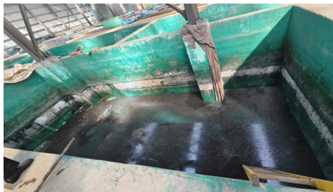
图 1 发生事故的腌制池
