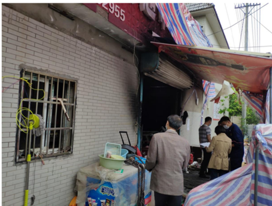
图 5 事故店铺火灾后外观图
