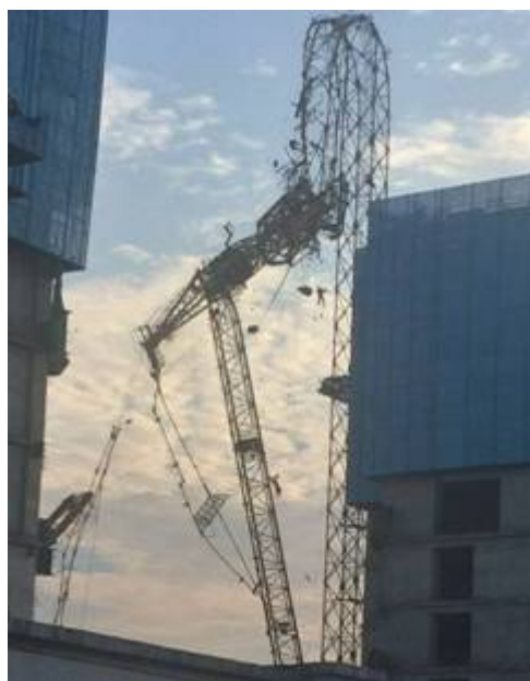
图2-2塔吊倾覆过程中结构宏观图
